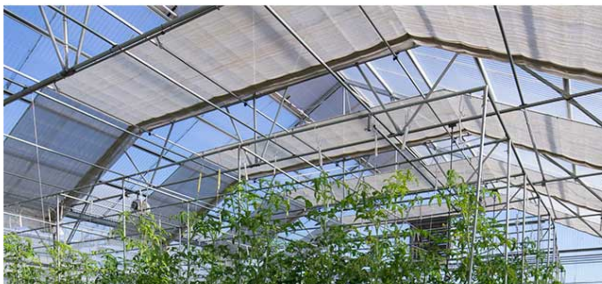
Slika 3. Sjenila na krovu platenika [4]
