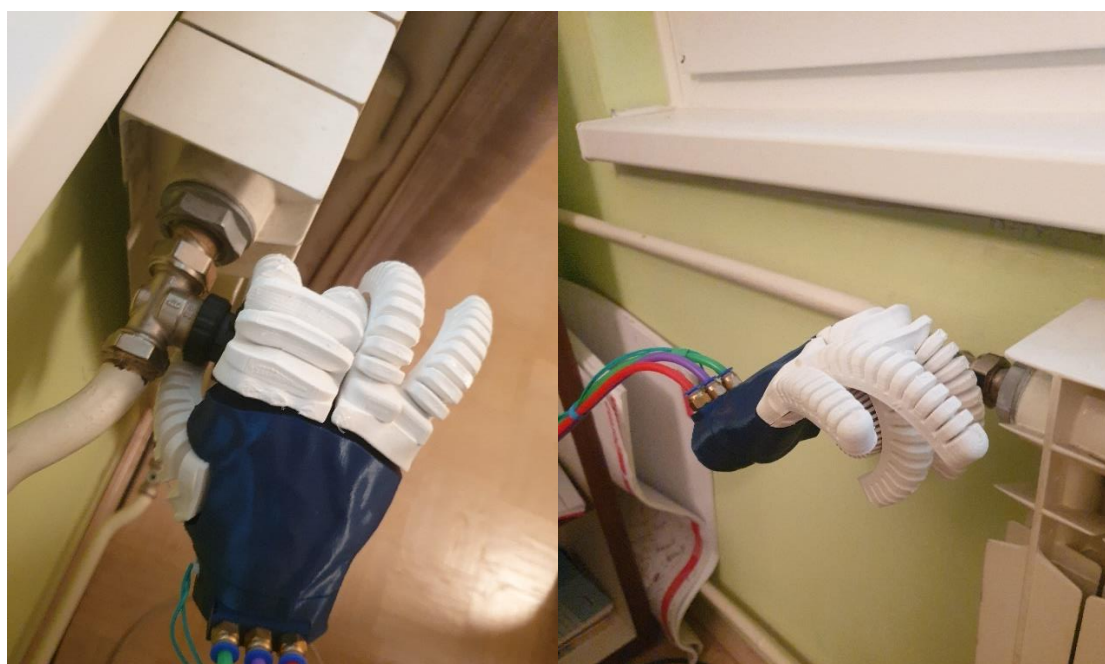
Slika 90. Puni hvat mekane robotske šake oko ventila radijatora
