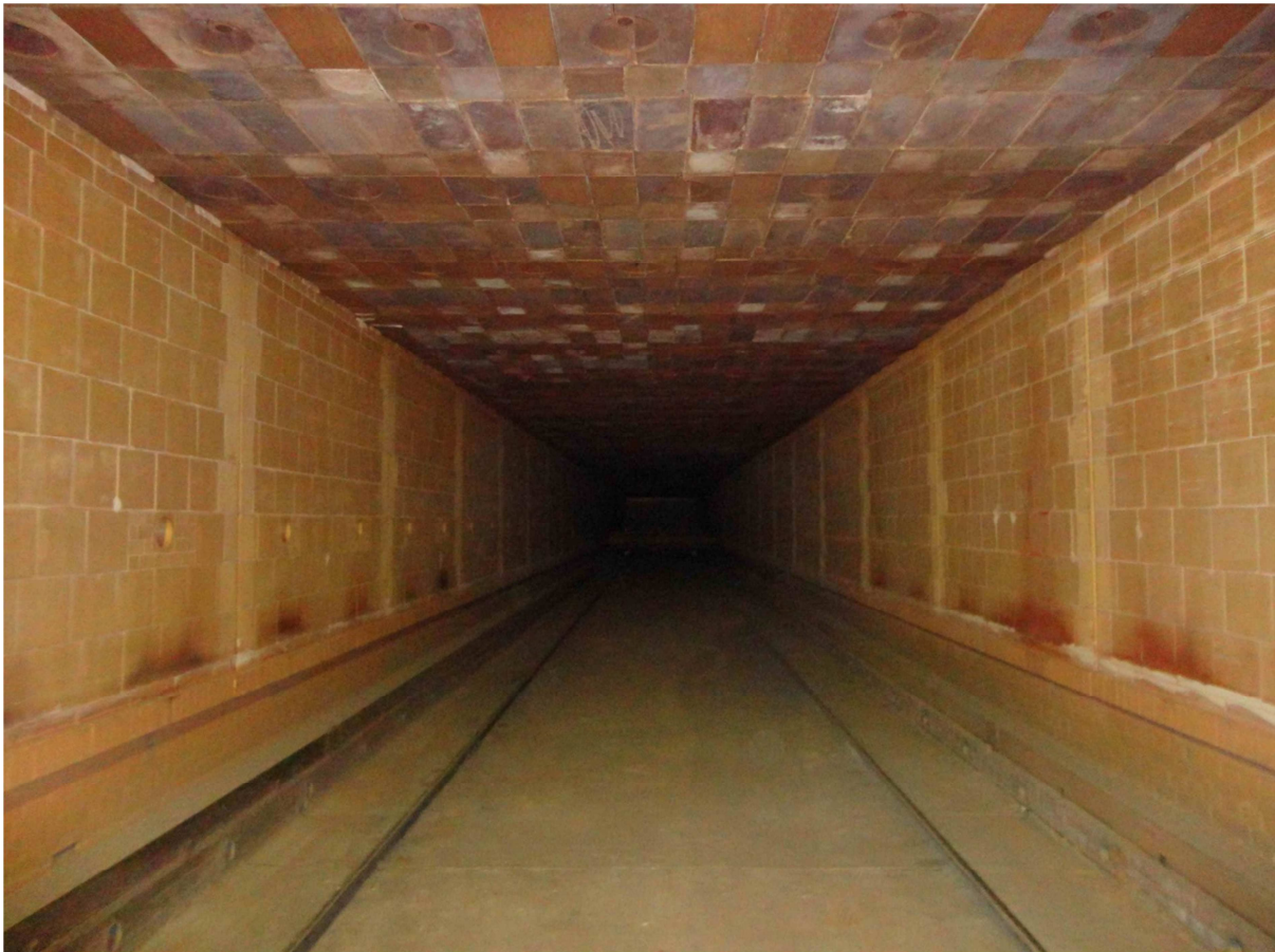
Slika 30. Unutrašnjost tunelske peći
