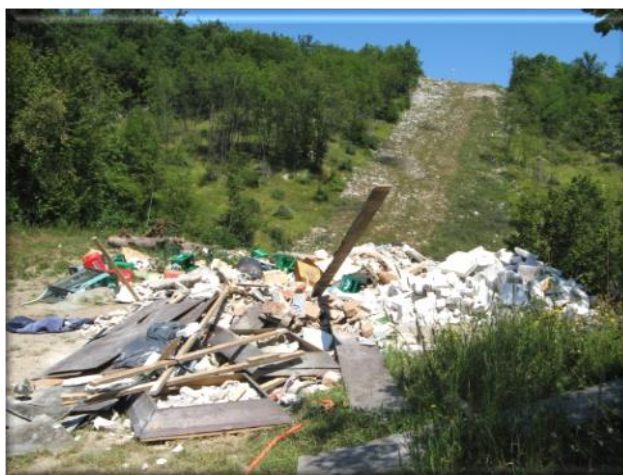
Slika 10.17 Narušavanje zaštitnog pojasa plinovoda [35]
