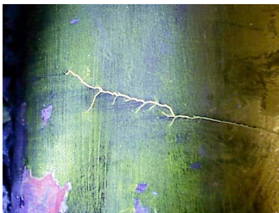
Slika 6.6 Oštećenja pri osvjetljavanju sa ultraljubičastom svjetlošću [73]
