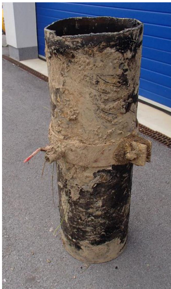
Slika 10.18 Odstranjen komad cijevi s ilegalno montiranim priključkom FG [33]
