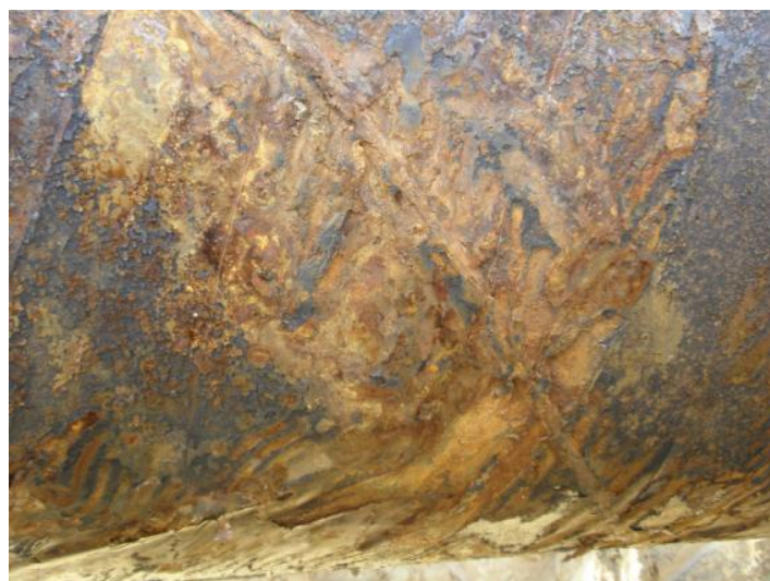
Slika 5.27 Oštećenja zbog vanjske korozije [33]
