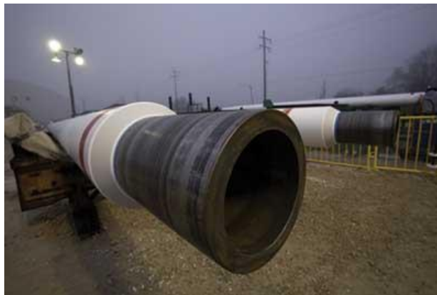
Slika 4.8 Kraj cijevi otežane betonskim prstenom [68]
