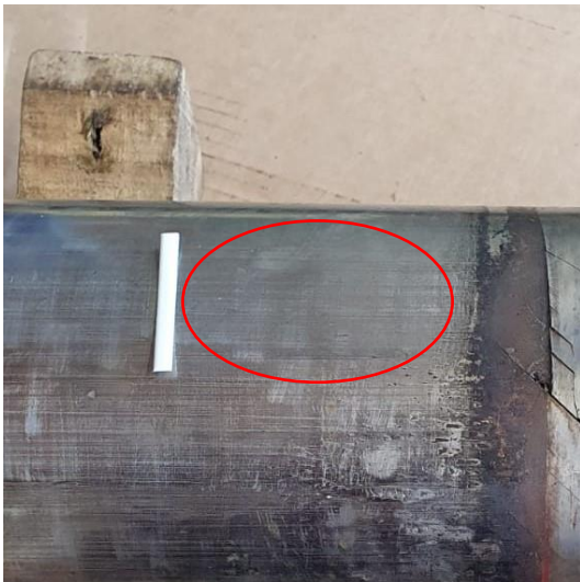
Slika 25. Segment A, referentna površina, pukotina s donje strane
