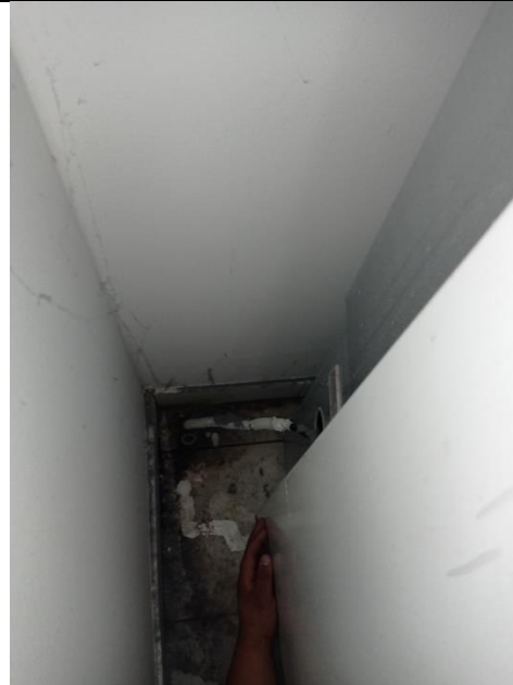
Slika 23. Odspojena cijev odvoda kondenzata
