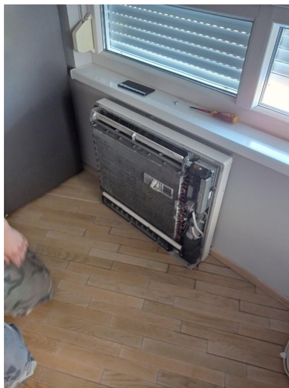
Slika 29. Ventilokonvektor sa skinutom maskom
