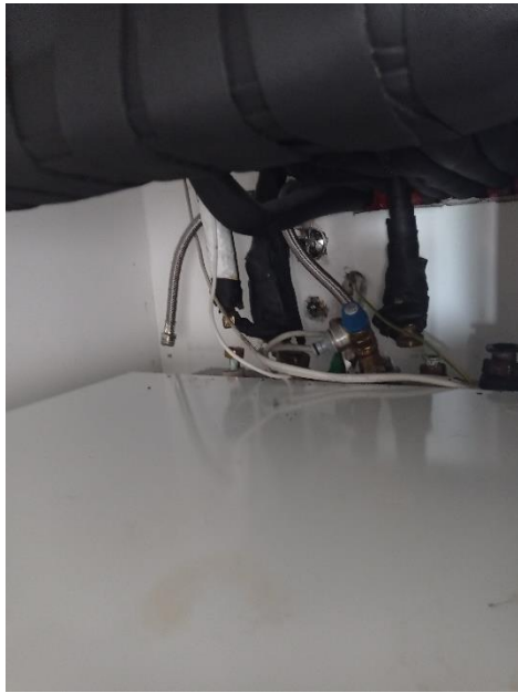
Slika 22. Odspojeni spojevi pri zamjeni nipli
