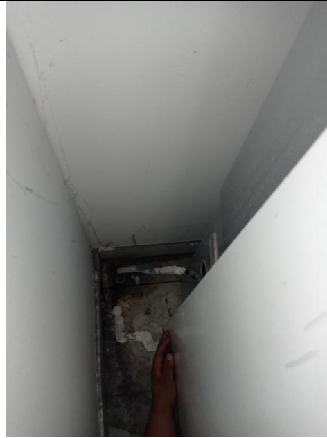
Slika 23. Odspojena cijev odvoda kondenzata
