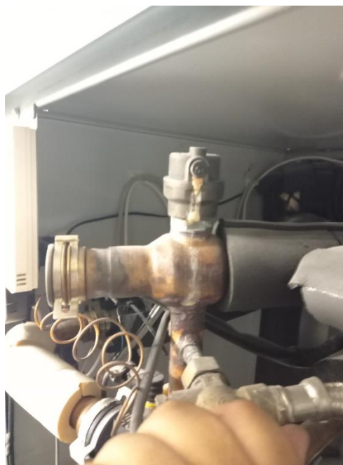
Slika 35. Odzračni lončić unutar hidrobox-a
