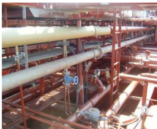
Slika 33. Cijevni sustav od nehrđajućeg čelika na palubi broda [30]
