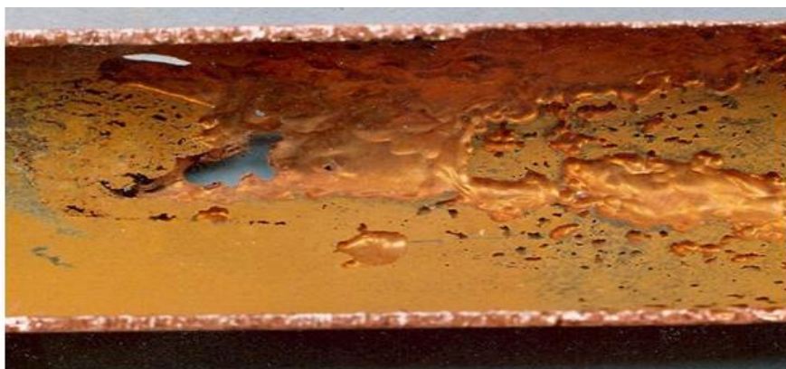
Slika 2.9 Erozijsko trošenje bakrene cijevi [8]
