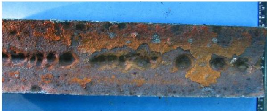
Slika 2.7 Oštećenje cjevovoda zbog djelovanja jamičaste korozije [5]
