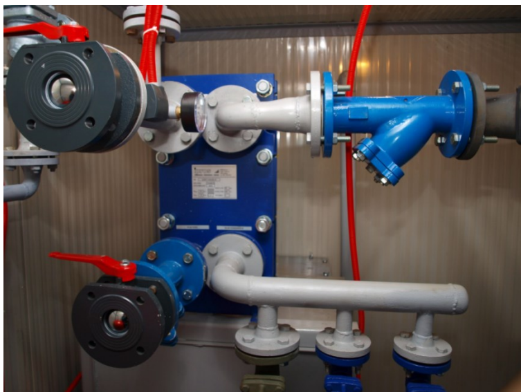
Slika 18. Toplinska podstanica unutar sušare [5]
