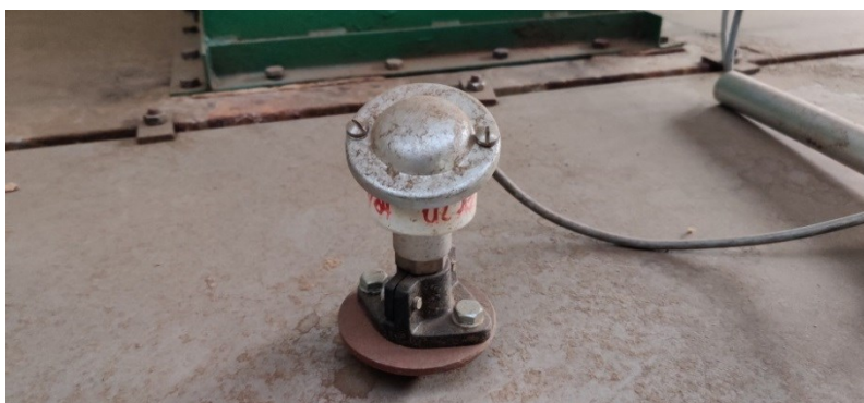
Slika 63. Senzor za očitavanje temperature unutar sušare – na krovu sušare
