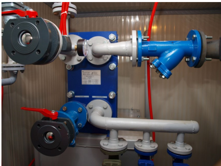
Slika 18. Toplinska podstanica unutar sušare [5]
