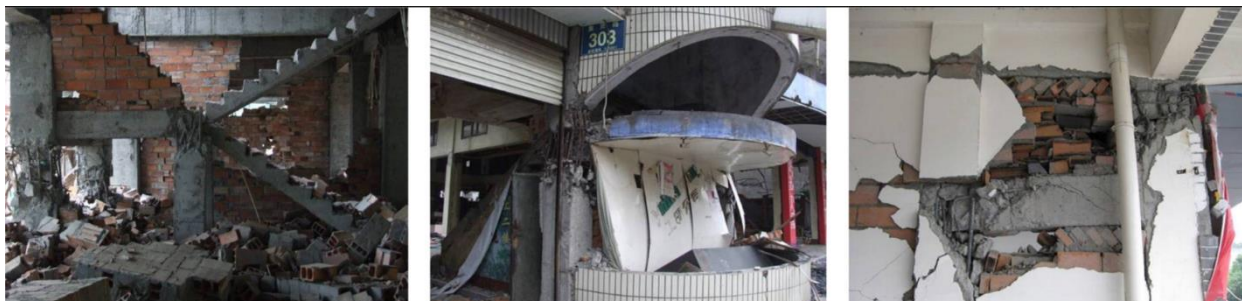
Slika 1. Unutrašnjost zgrade nakon potresa
