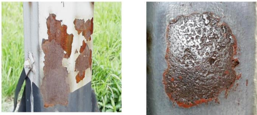
Slika 3: Prikaz ravnomjerne i neravnomjerne opće korozije [5]
