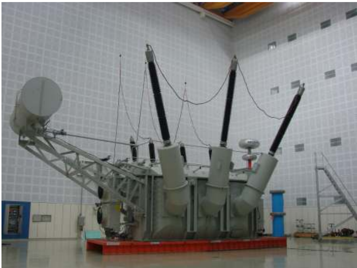
Slika 38 Transformator u ispitnoj stanici
