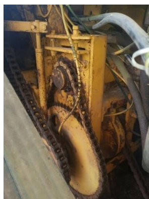
Slika 2.7. Zatečeno stanje mehaničkog dijela pogona
