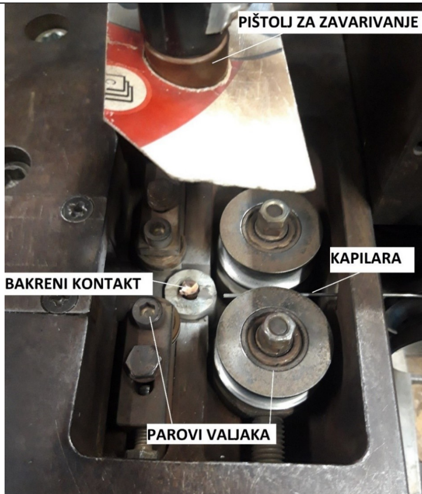
Slika 24. Otvorena komora za zavarivanje
