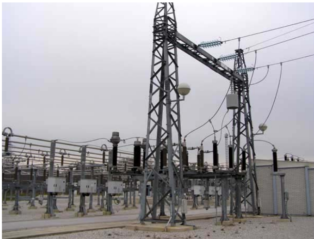
Slika 2 - 1: Mjerni transformatori ugrađeni na TS 400/220/110 kV Žerjavinec
