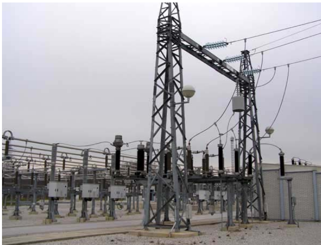
Slika 2 - 1: Mjerni transformatori ugrađeni na TS 400/220/110 kV Žerjavinec
