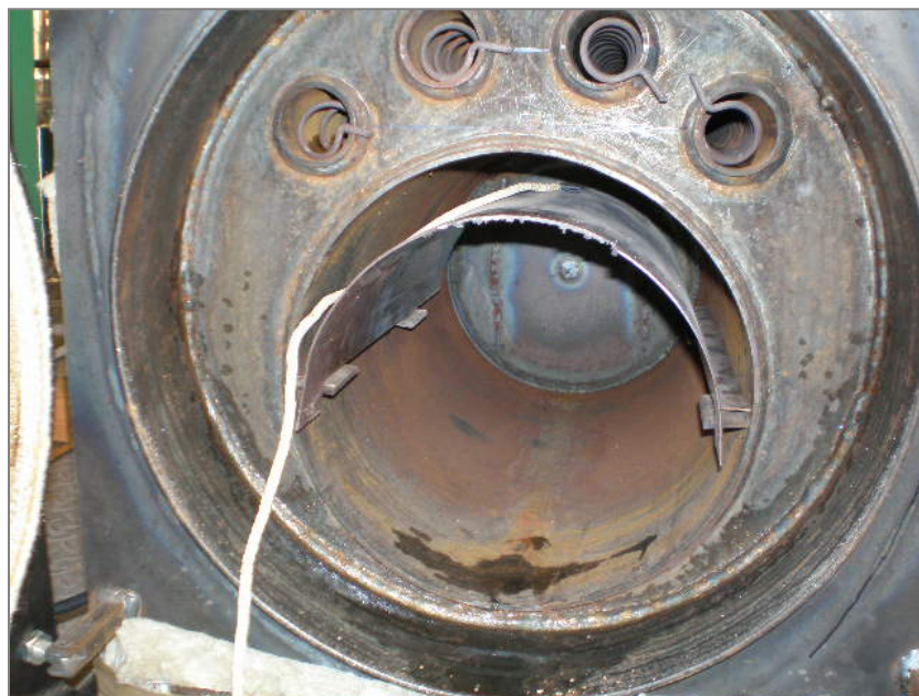
Slika 6.21 Kondenzacija dimnih plinova na trećoj izvedbi prototipa NTK25
