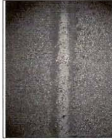
Lc3, vidljiva poprečna puknuća
