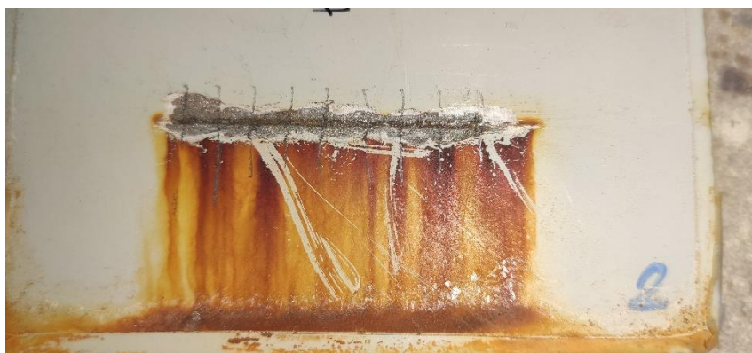
Slika 5.48. Urez pripremljen za mjerenje zone korozije na uzorku broj 2
