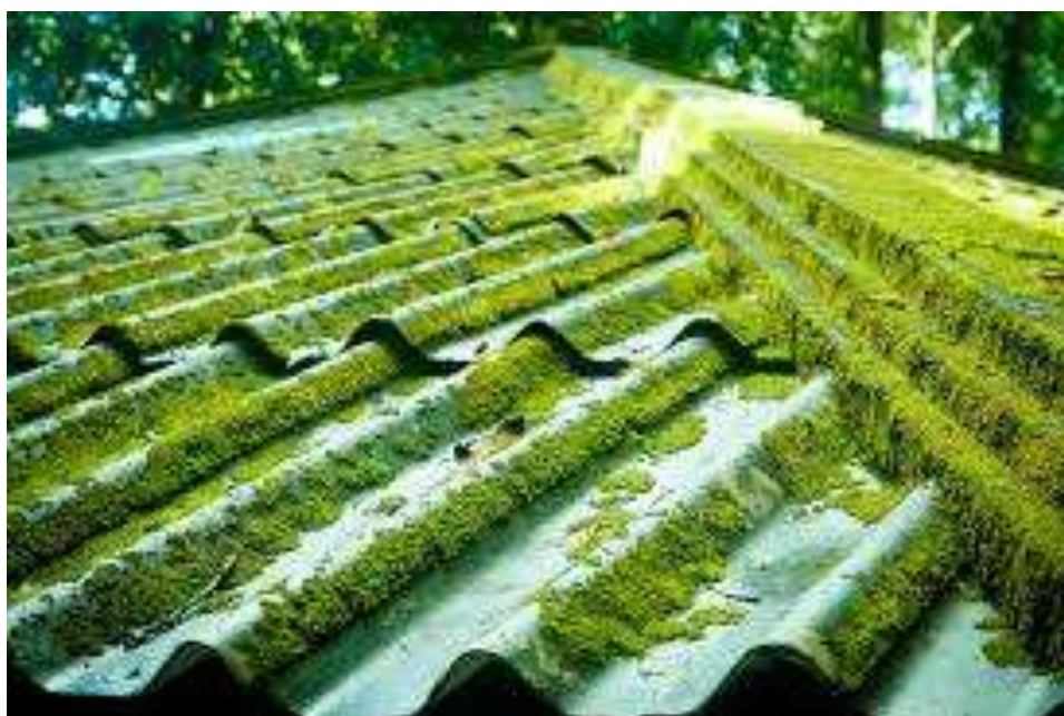
Slika 9. Mahovina na limenom krovu [6]
