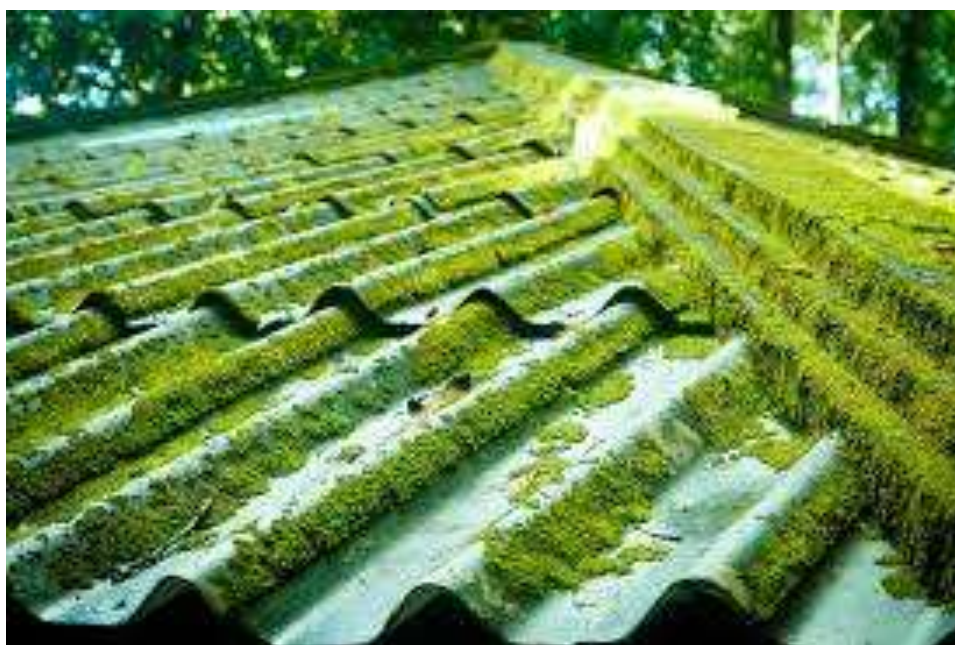
Slika 9. Mahovina na limenom krovu [6]
