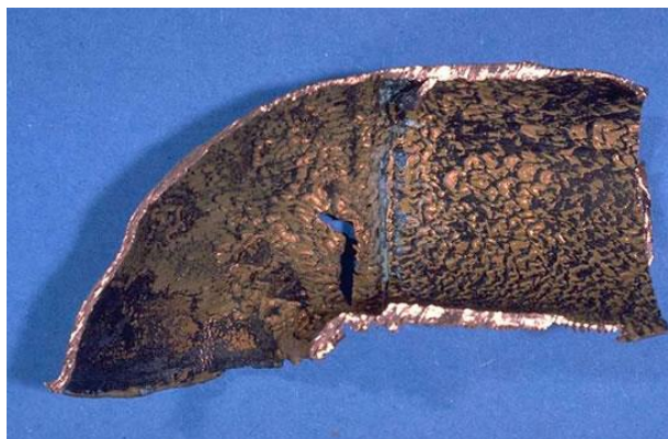
Slika 2.7. Erozijsko-korozivna oštećenja tipa "potkovicica" u bakrenom cjevovodu [5]
