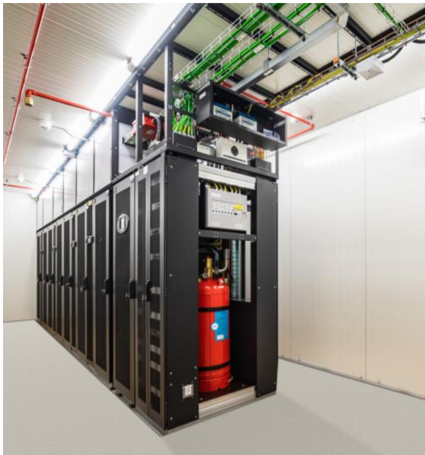
Slika 7. Unutrašnjost podatkovnog centra [13]
