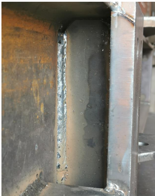
Slika 17. Primjer površinske korozije
