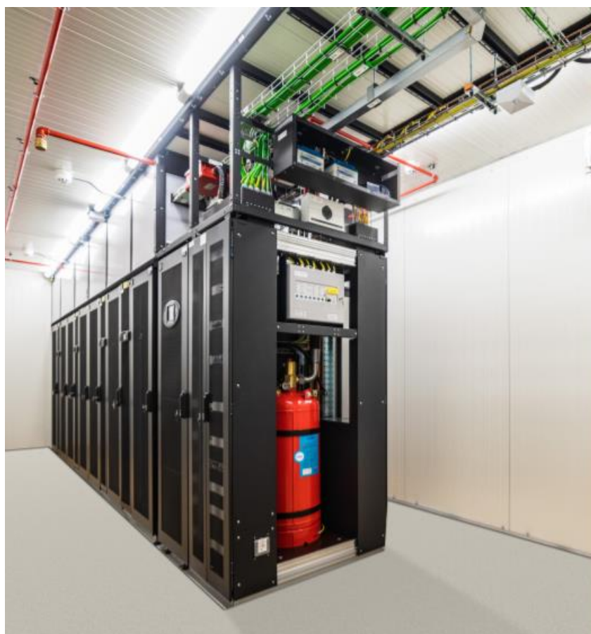
Slika 7. Unutrašnjost podatkovnog centra [13]
