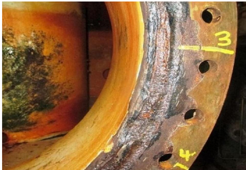
Slika 20. Oštećenje prirubnice od ugljičnog čelika nastalo nakon samo 3 mjeseca, a uzrokovano korozijom u procijepu spoja prirubnica [26]
