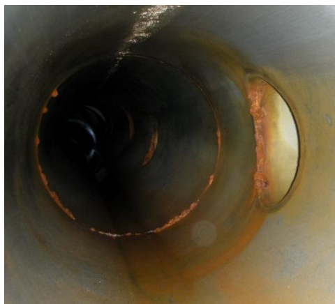
Slika 31. Nakupine bakterija na zavarenom spoju stijenke cijevi od čelika EN 1.4307 [33]
