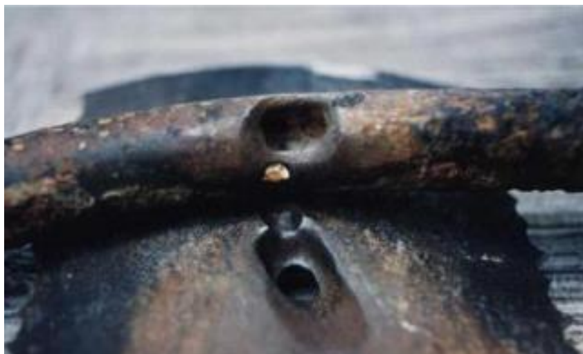
Slika 13. Korozija plinovoda u Guadalajari, Meksiko [15]
