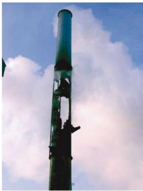
Slika 11. Strukturno nestabilan dimovod [13]
