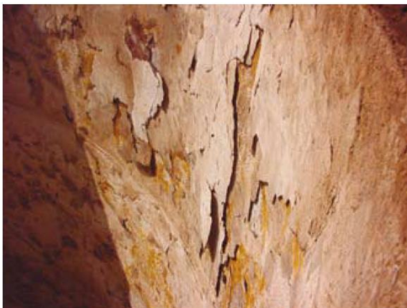
Slika 10. Unutrašnjost čeličnog dimovoda oštećenog korozijom [13]
