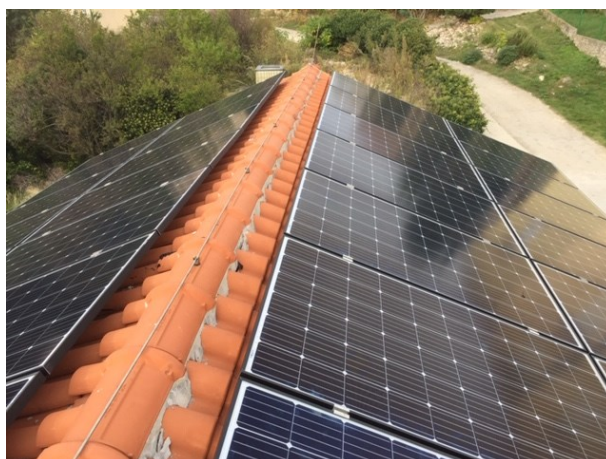
Slika 13. Fotonaponska elektrana na krovu desalinizatora [40]
