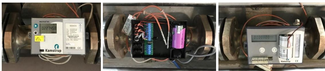
Slika 26. Montaža i priključivanje brojača impulsa na ispitivano mjerilo protoka
