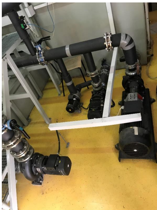
Slika 20. Tri Pumpe za potrebe dobave vode
