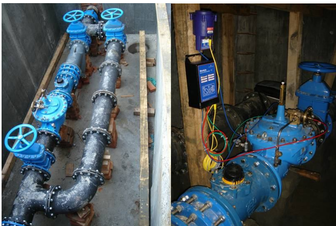
Slika 4.5. Mjerno-regulacijska komora za kontrolu protoka regulacijom tlaka na ulazu u DMA
