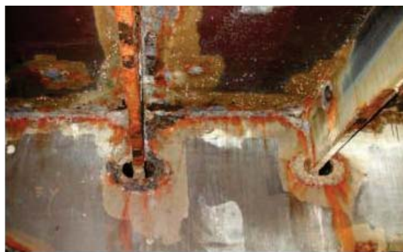
Slika 2.10 - Uznapredovala korozija potpalublja 20 godina starog tankera
