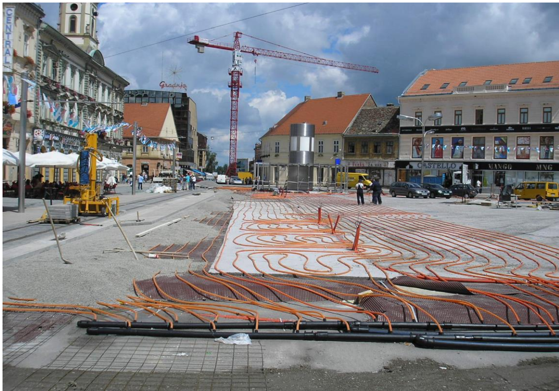
Slika 5.6. Priključenje podnog grijanja Trga A. Starčevića u Osijeku na vrelovodni sustav
