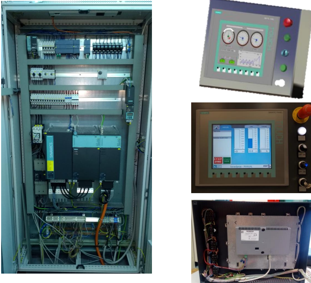
Slika 2.17. Upravljački ormar kočnice (lijevo) i HMI (desno)
