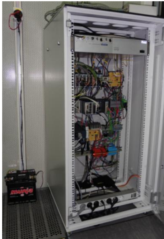
Slika 2.14. Ormar s elektroničkim komponentama za upravljanje radom motora
