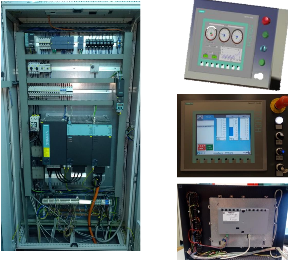
Slika 2.17. Upravljački ormar kočnice (lijevo) i HMI (desno)
