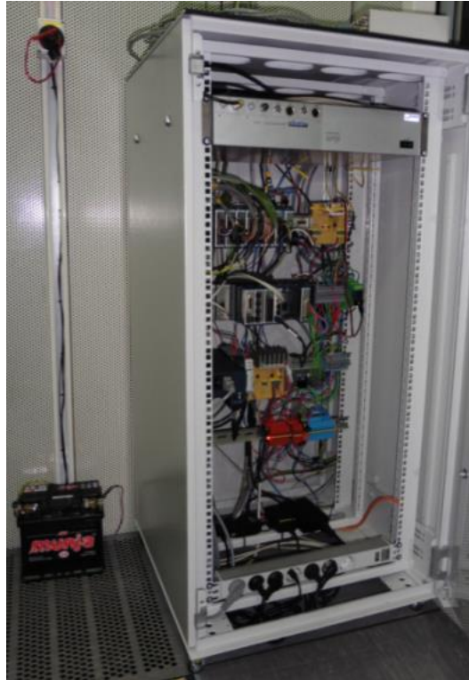
Slika 2.14. Ormar s elektroničkim komponentama za upravljanje radom motora
