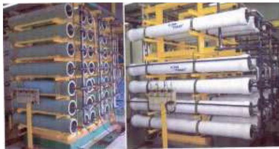
Slika 9. RO moduli u postrojenju za desalinizaciju
