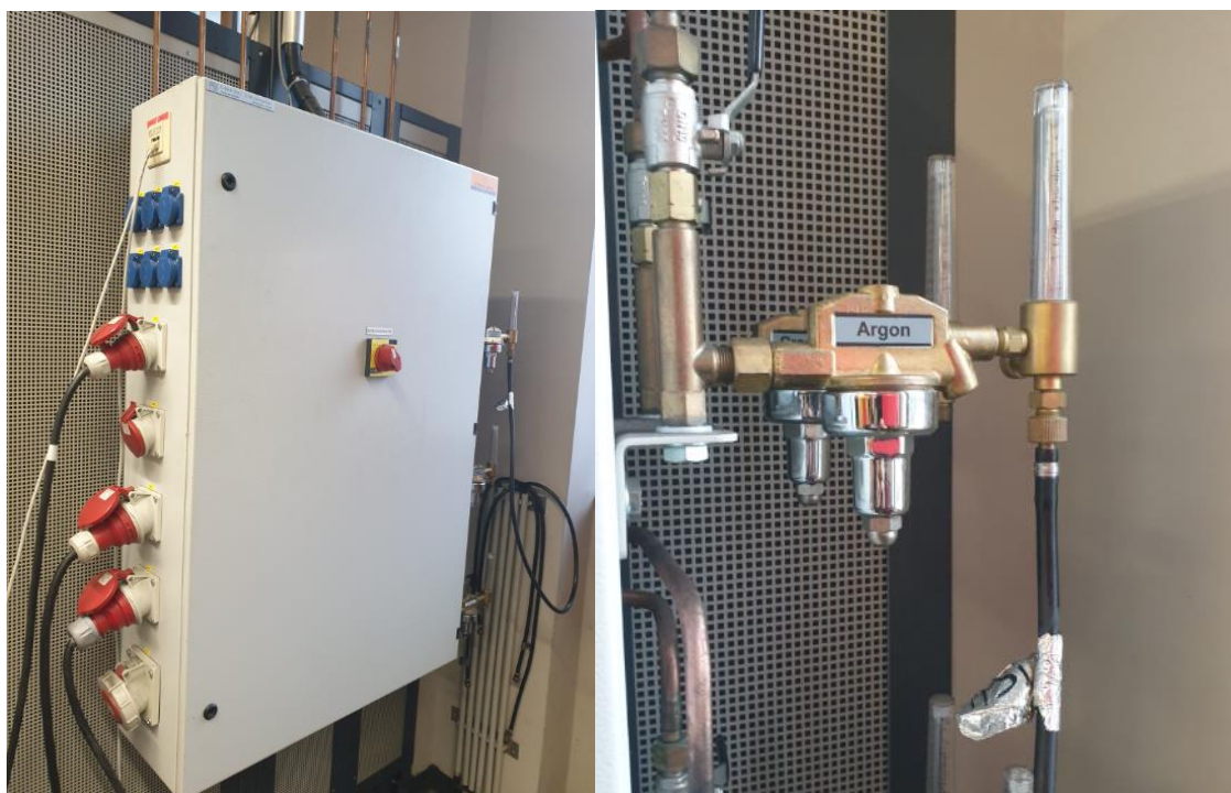
Slika 63. Stanica zaštitnog plina (lijevo) i priključak za dovod (desno)
