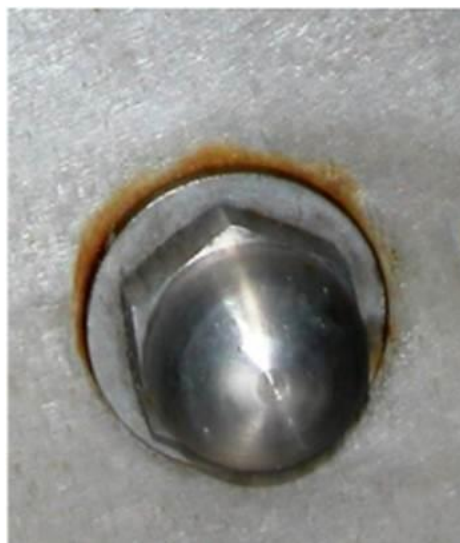
Slika 8. Primjer korozije u procjepu [13]
