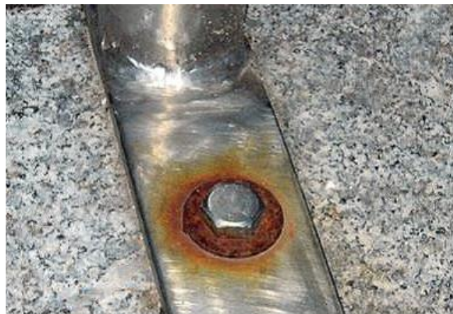
Slika 6. Primjer galvanske korozije [9]
