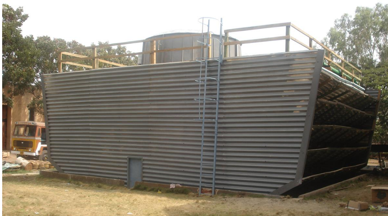
Slika 12. Rashladni toranj izrađen od drveta
