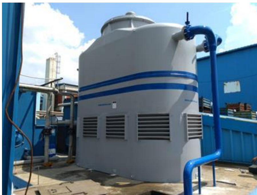
Slika 14. Rashladni toranj izrađen od staklenih vlakana
