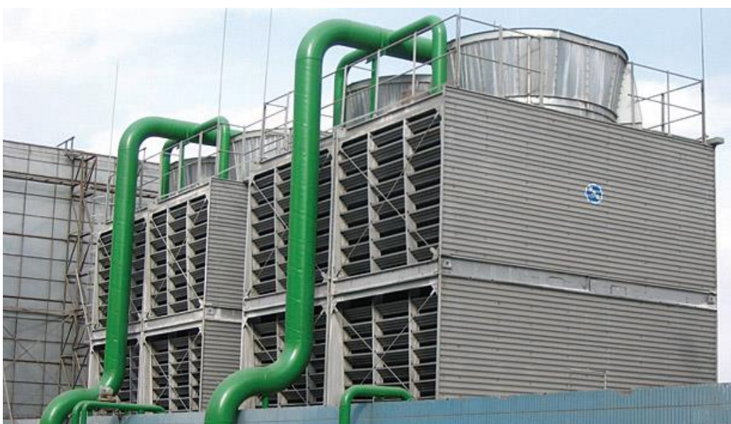
Slika 13. Rashladni toranj izrađen od galvaniziranog čelika
