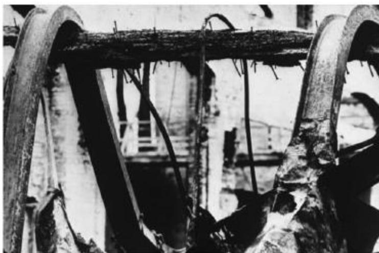
Slika 3.14. Drveni i čelični nosači nakon požara [7]
