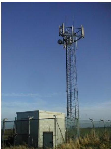
Slika 1. Primjer bazne stanice
