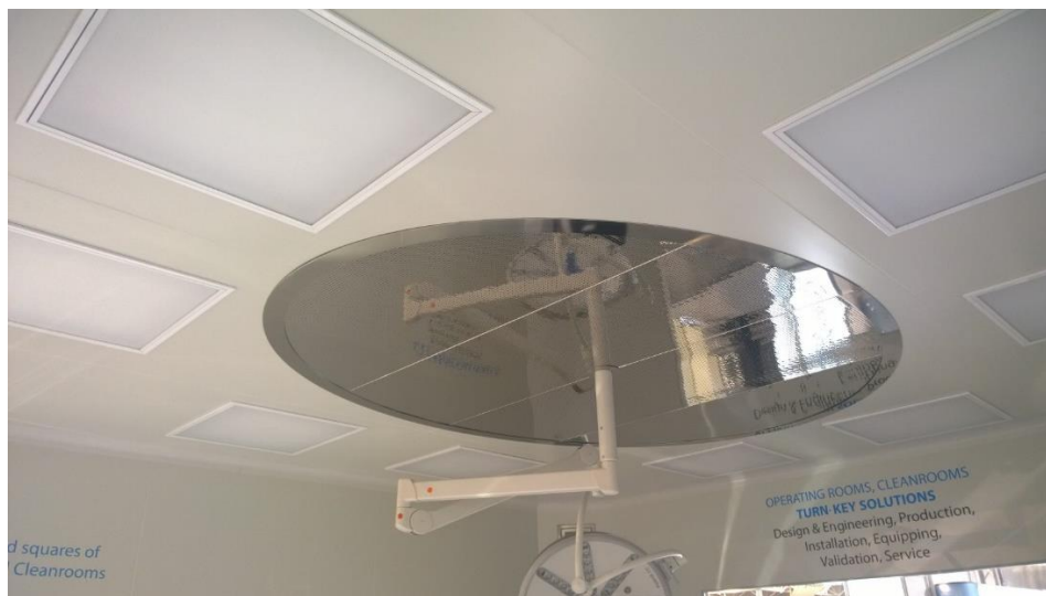
Slika 2.1 Ovalni operacijski strop s HEPA filtrom
