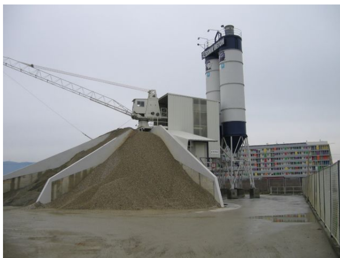
Slika 1. Betonara tipa „zvijezda“
