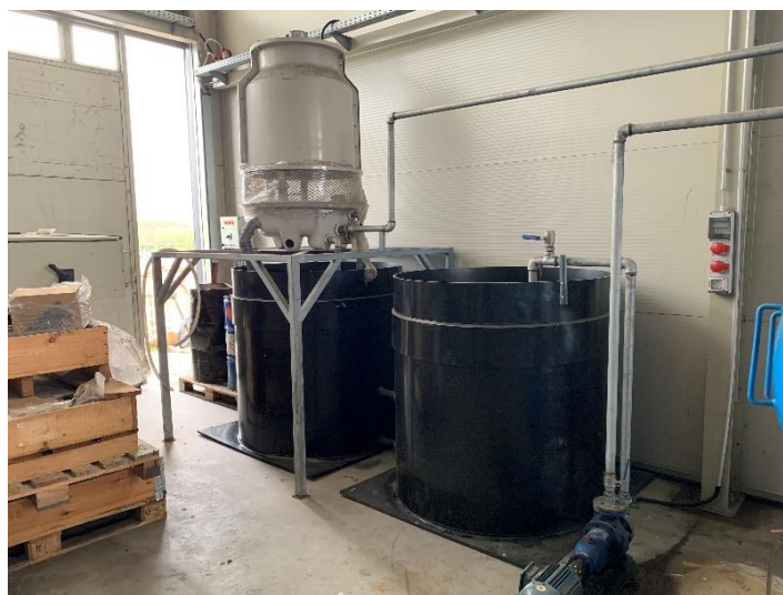
Slika 51. Spremnici i uređaj za hlađenje vode
