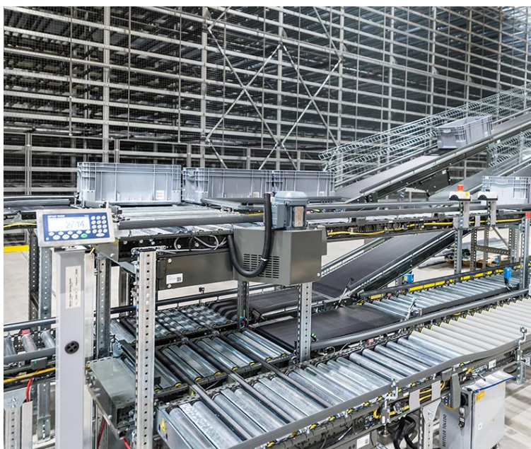
Slika 1. Primjer dijela transportnog sustava automatiziranog skladišta
