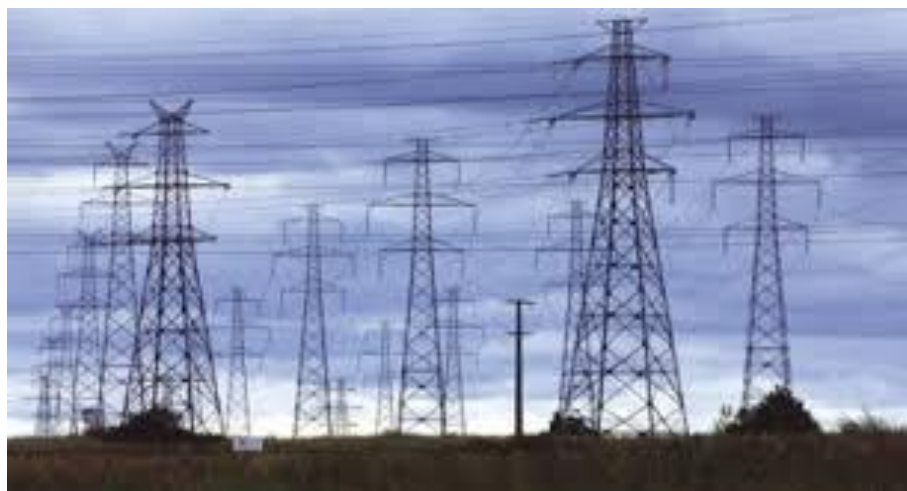
Slika 19 Dalekovod kao tipični primjer pocinčanog čelika [18]
