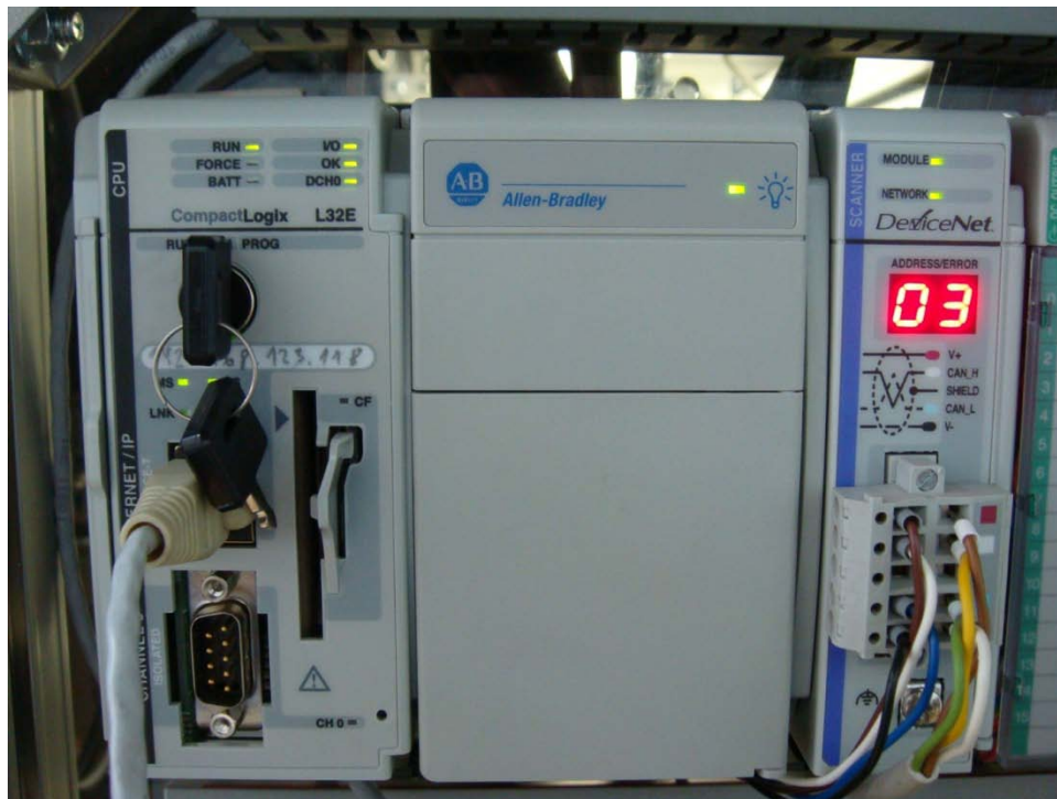
4.11. Device net i CompactLogix L32E centralna upravljačka jedinica
