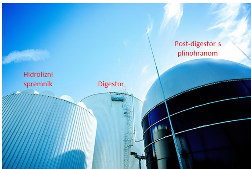
Slika 3.10. Spremnici opisanog bioplinskog postrojenja
