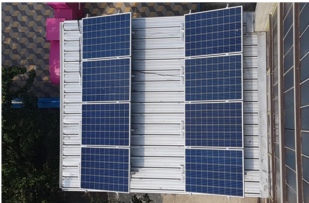
Slika 6. Sunčana elektrana od 2,16 kW
